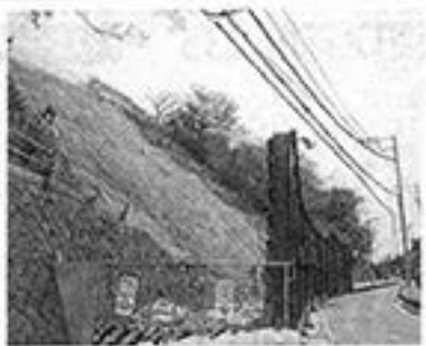
横須賀市は市道(右)の復旧と保護のため、土砂崩れが起きた斜面の寄付を受けることが決まっている。横須賀市ハイランド1丁目
