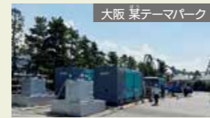
リニューアル工事期間中の非常用発電機として使用。
