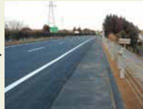
応急復旧後の状況 (2011年3月17日17時頃)
