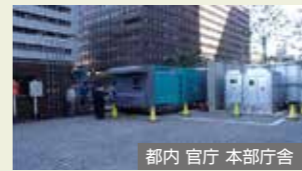
既設発電機の更新に伴う非常用発電機として使用。
