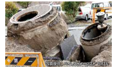
液状化によって飛び出したマンホール。重いビルや橋は沈み、軽いマンホールなどは浮き上がってくる。
